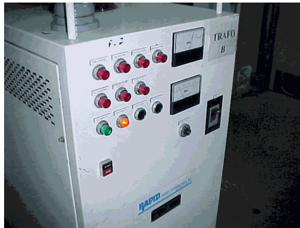
Transformador y rectificador B
