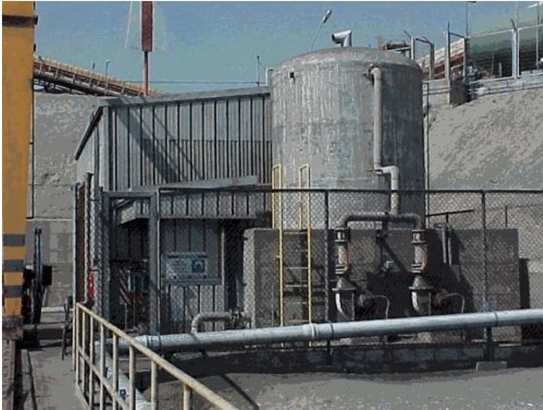
Tanque de almacenamiento de hipoclorito
