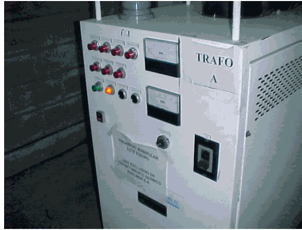
Transformador y rectificador A
